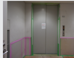
搬入出用エレベーター
